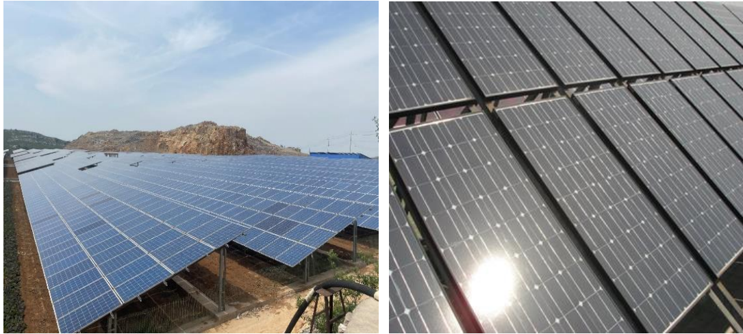
图 2.10 淄博新明珠光伏发电中心
